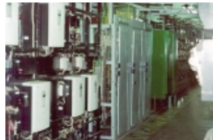
Рис. 3. Главное распределительное помещение полностью автоматизированного цеха
