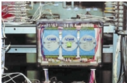
Рис. 9. Блок из трех модулей ADAM на монтажной панели магнитного усилителя
